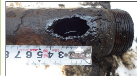
【腐食した埋設配管】
